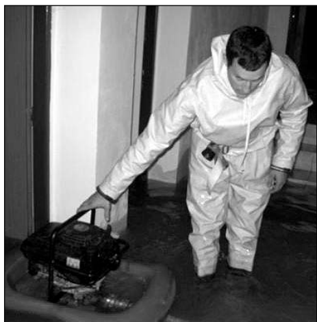
■ Odčerpávání vody ze zaplaveného sklepa
