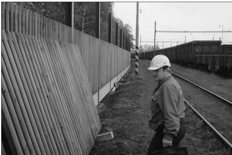
■ Jedna z protihlukových stěn v Radvanicích
